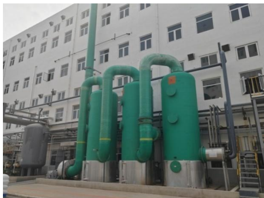
B1/C1 车间三级吸收塔
