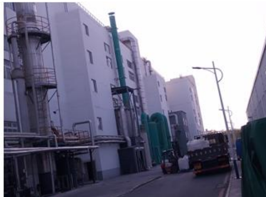
B2 车间三级吸收塔
